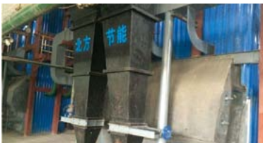
竣工后的循环流化床锅炉外景图
